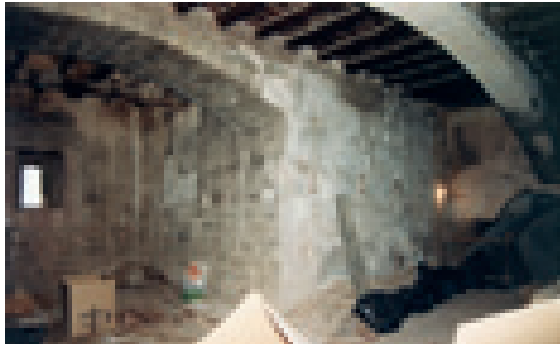
Antigua iglesia, previo a la intervención y tras la intervención, zona bajo coro
