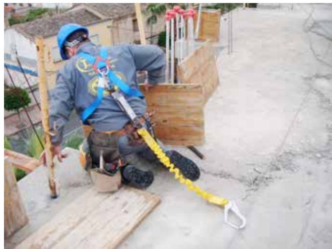
Imagen: Utilización de equipo de protección individual, en fase de estructura, y ante la ausencia momentánea de protección colectiva perimetral. Fuente: Fernando Espinosa Gutiérrez
