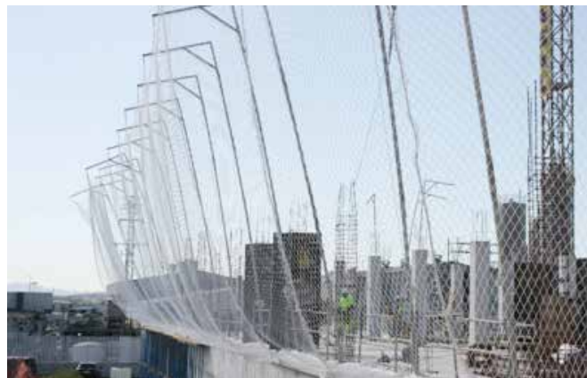
Imagen: Redes verticales tipo V para limitación de una posible caída. Fuente: Fernando Espinosa Gutiérrez
