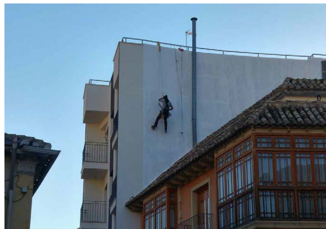
Imagen: Utilización de equipo de protección individual, en fase de estructura, y ante la ausencia momentánea de protección colectiva perimetral. Fuente: Fernando Espinosa Gutiérrez
