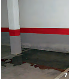
Fig. 7: filtración por el encuentro solera-muro.
