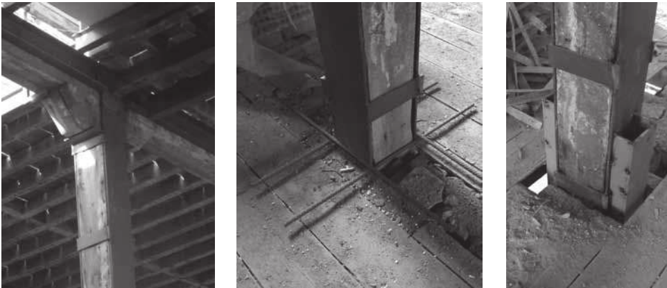
Figuras 9, 10 y 11. Diversos detalles del refuerzo estructural realizado. Fuente: imagen de los autores.
