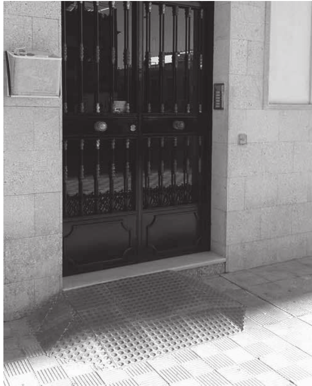
Figura 1. Ejemplo de acceso a edificio residencial, resuelto de manera inadecuada.
