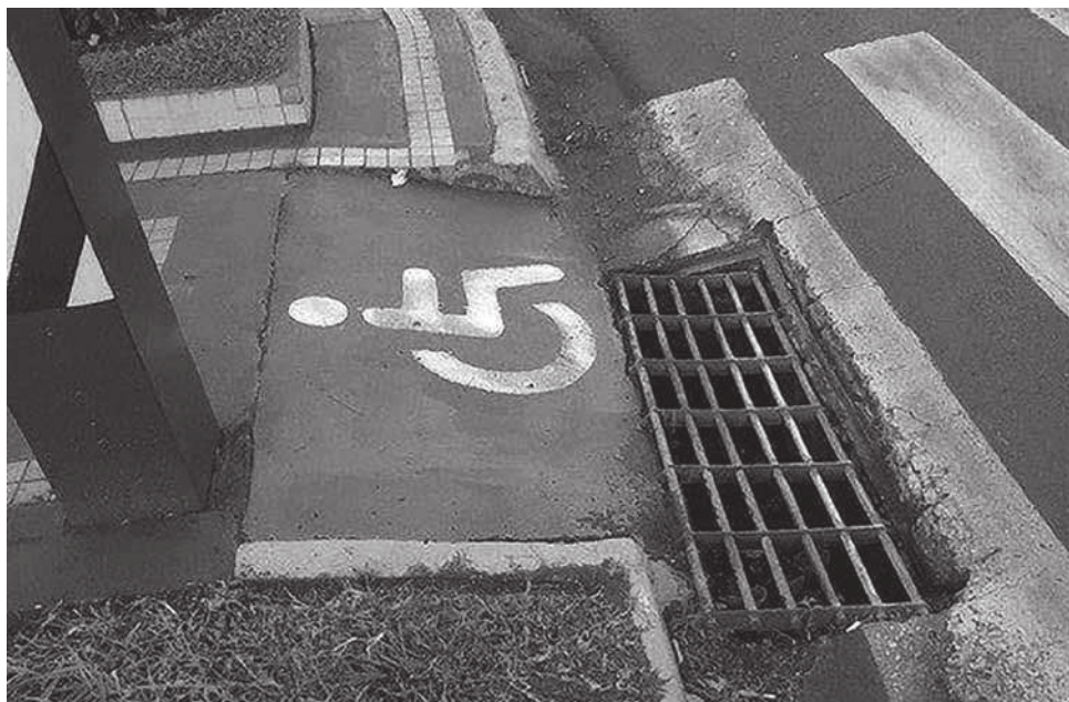
Figura 3. Ejemplo de vado peatonal resuelto de manera errónea y peligrosa, en Ecuador. Fotografía tomada por Carlos Harold Caicedo Tapia, consultor en accesibilidad universal y diseño para todos.
