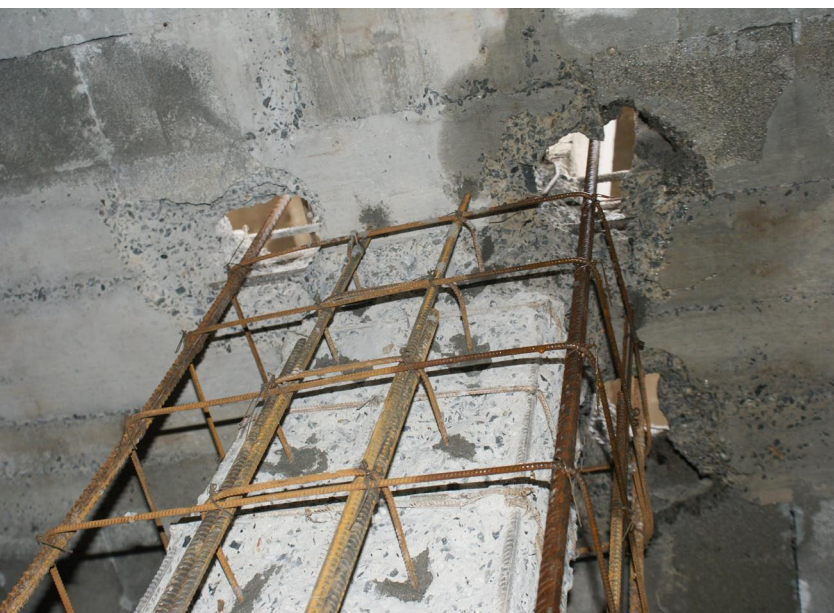
Figura 9. Refuerzo de un pilar con encamisado en micro-hormigón, con uniones y continuidad entre pisos.
