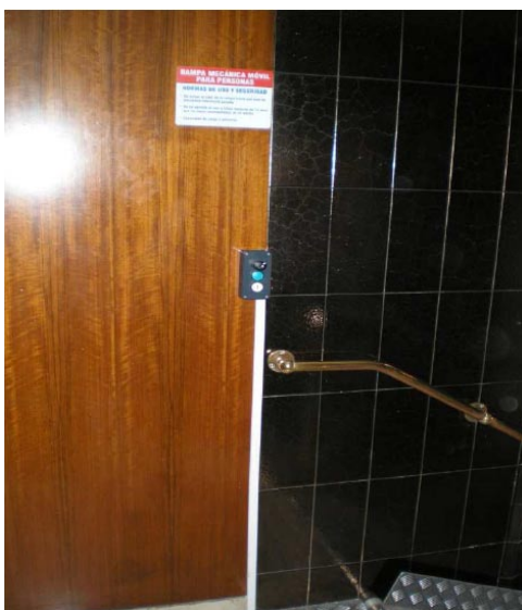
Mecanismo de elevación en parte alta
