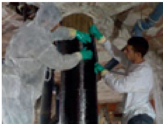
Aplicación de las bandas de tejido impregnados por saturación en resina epoxi SIKADUR 300 con la que también se cubre el pilar. Se respetan los solapes y se pasa el rodillo metálico para mejorar la saturación y adherencia
