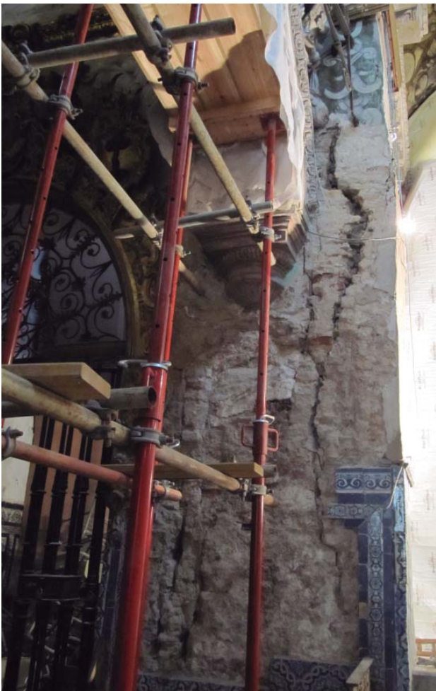
Estado de deterioro que presentaba la pilastra, con apuntalamiento del arco como medida preventiva
