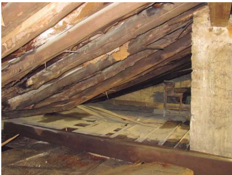
Estado de flexión y rotura que presentaban los pares de cubierta antes de la intervención
