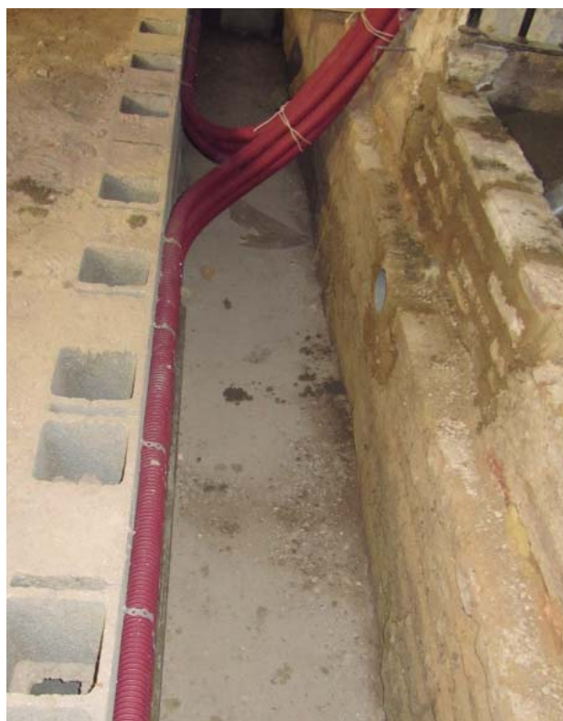
Canal de ventilación perimetral a los muros para ventilación
