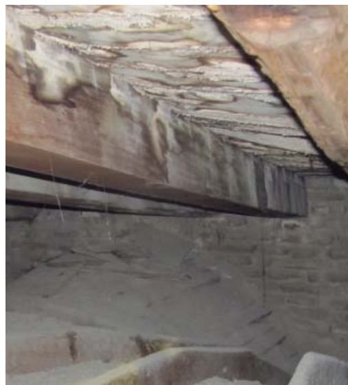
Presencia de humedades y hongos
