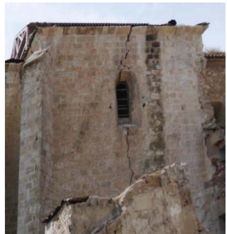
Foto 7. Grieta en ábside
