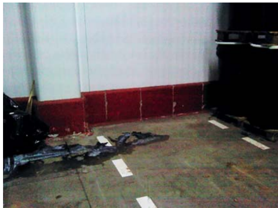
1-Cámara frigorífica en nave agrícola
