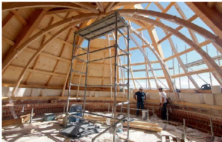
Figura 3. Restauración de la Iglesia de Santiago Apóstol, en Lorca (Múrcia). Origen: Cercha 140, pp. 64-70
