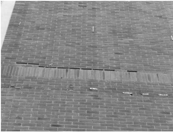
Figura 4. Daños ladrillo en fachada.
