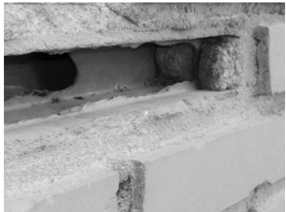
Figura 7. Detalle daños en ladrillo
