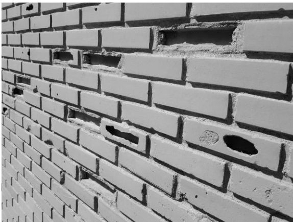
Figura 6. Detalle daños en fachada.
