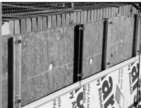
Figura 18. Aislante adherido a fachada en fachada
