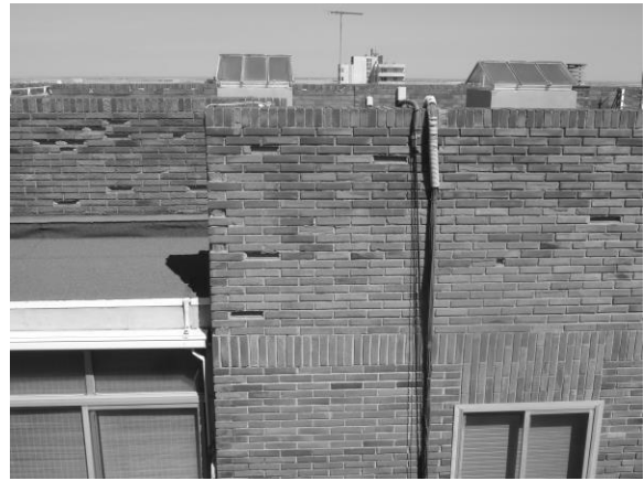
Figura 5. Daños ladrillo y cableado existente
