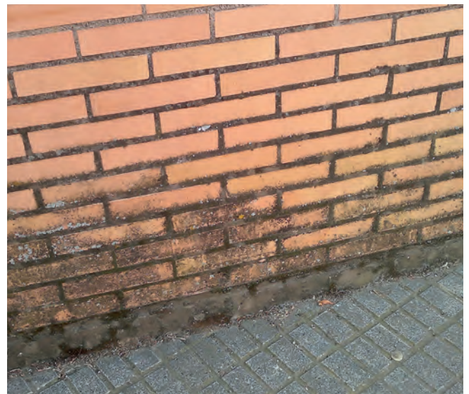
Figura 11: humedad en la parte inferior de una fachada cara vista, debida a la falta de zócalo.
