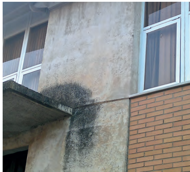
Figura 8: humedad debida a una solución inadecuada entre la fachada y el alero de hormigón.
