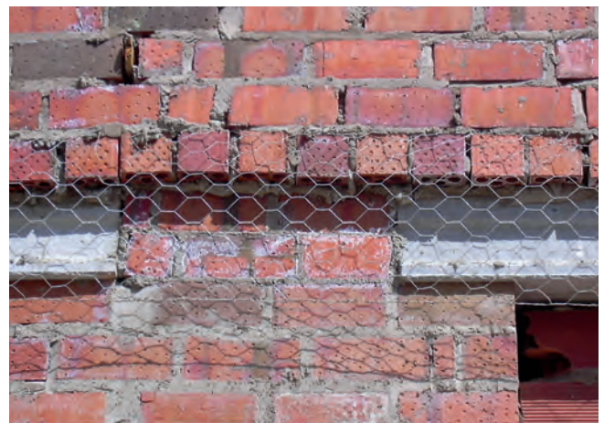
Figura 6: solución (mal ejecutada) en la que el dintel se realiza con vigueta doble T y se adiciona una malla metálica con solape en vertical insuficiente.
