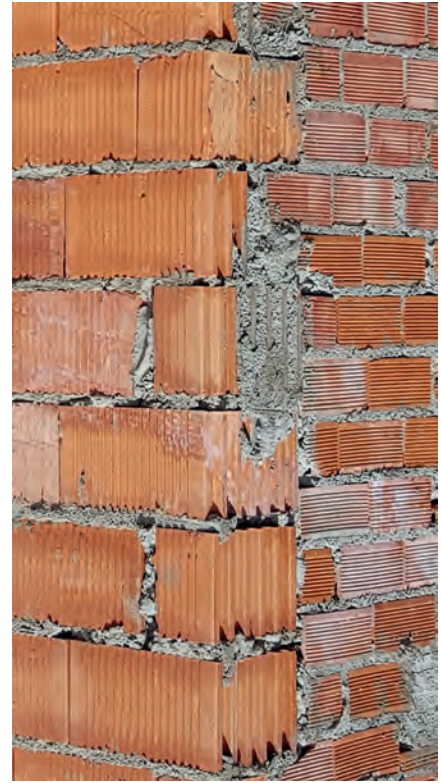
Figura 7: esquina de fachada donde converge el sistema Termoarcilla® y el tradicional de ladrillo. Se aprecian cortes inadecuados de piezas, macizados con cemento y enjarjes insuficientes.
