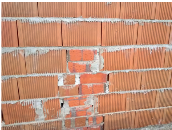
Figura 3: inclusión de varios ladrillos perforados entremezclándolos en una fábrica de bloques cerámicos aligerados (incorrecto).
