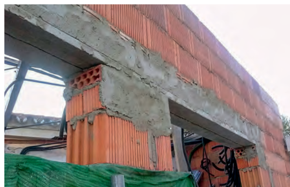
Figura 2: apoyos inadecuados bajo dinteles realizados con ladrillo.
