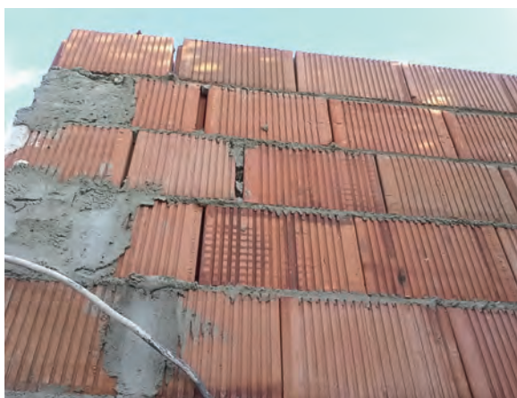
Figura 4: aberturas de encaje de las juntas verticales con espesores diferentes y con la inclusión en algún otro caso de mortero de cemento (incorrecto).
