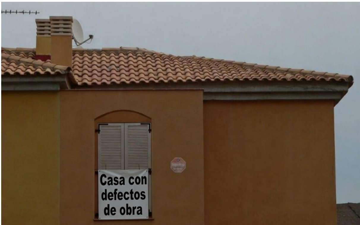
Figura 1. Imagen de quejas en la fachada de una nueva promoción inmobiliaria en una urbanización. Fuente: Autor de esta comunicación en la que actuaba de perito judicial.
