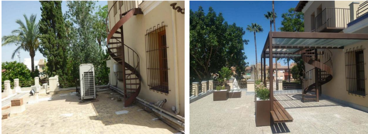
Figura 5. Antes y después de la rehabilitación de la terraza de planta 1ª.
