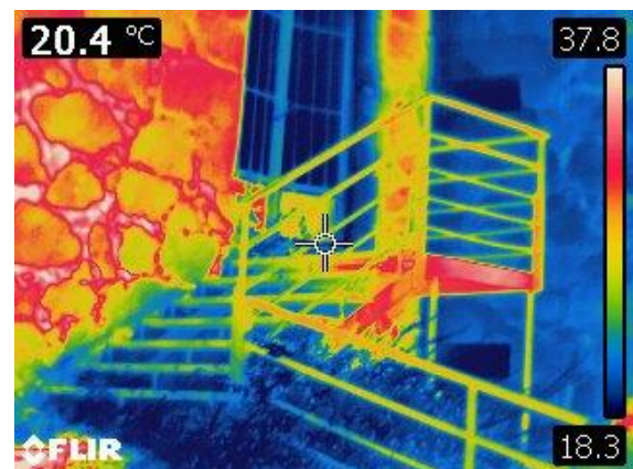
Figura 2. Toma termográfica escalera metálica de acceso al castillo, con proliferaciones bajo la misma
