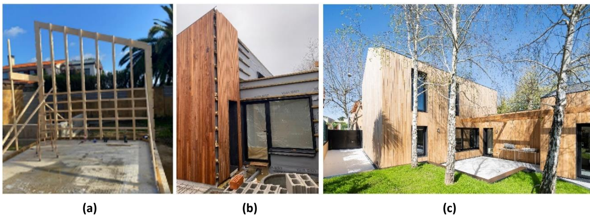
Figura 1. Fotos de proyecto: (a) Estructura. (b) Cerramiento. (c) Resultado. Fuente: Elaboración Propia
