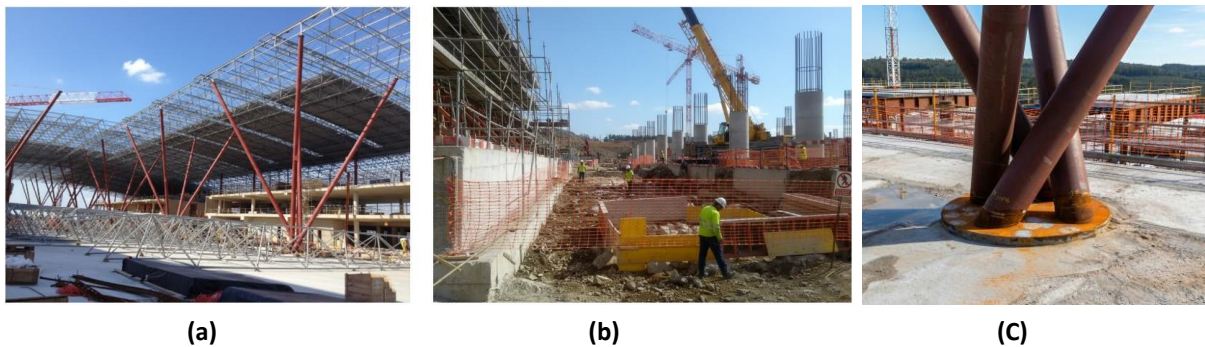
Figura 3. Nueva terminal de Lavacolla: (a) Detalle cubierta. (b) Cimentaciones. (c) Detalle pilar metálico.
