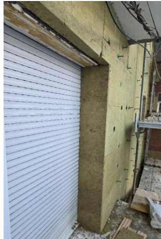
Figura 4. Proceso de ejecución del SATE: colocación de paneles de lana de roca. Fijación mecánica y adhesiva.
