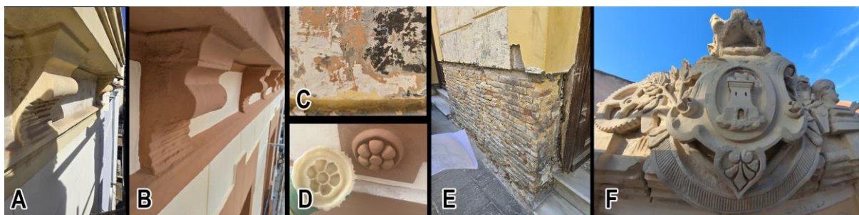
Figura 3. Vistas de la intervención en fachada (A) y (B) Vistas de la cornisa antes y después de la actuación (C) Estratigrafía realizada para la localización de las distintas capas de pintura y sus colores (D) Vista del molde en silicona de la decoración floral de una de las piezas perdidas (E) Fase de eliminación del zócalo de morteros y consolidación de la base de ladrillo. (F) Vista del escudo que corona la fachada en su fase restaurada. Fuente: Los autores
