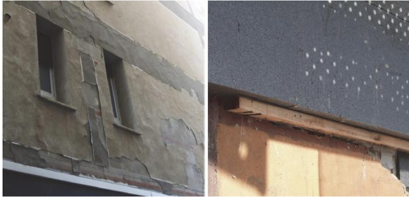
Figura 5. Ejemplo de imágenes de patologías. Fuente: M. Epelde, A. Intxausti.
