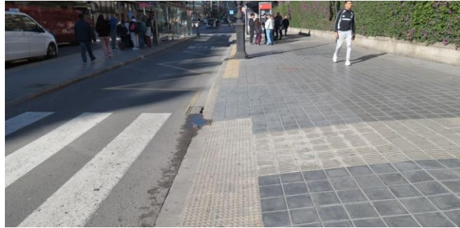
Figura 1. Pavimento Calle Xátiva
