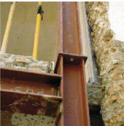
Unión articulada entre pilares. Pérdida de dos coacciones. No se ha soldado la placa de pie de soporte superior sobre la placa de cabeza de soporte inferior.
