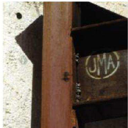
Articulación incorrecta. Quizás la unión de mas momento del debido. El soporte se sobrecarga y la viga se alivia.
