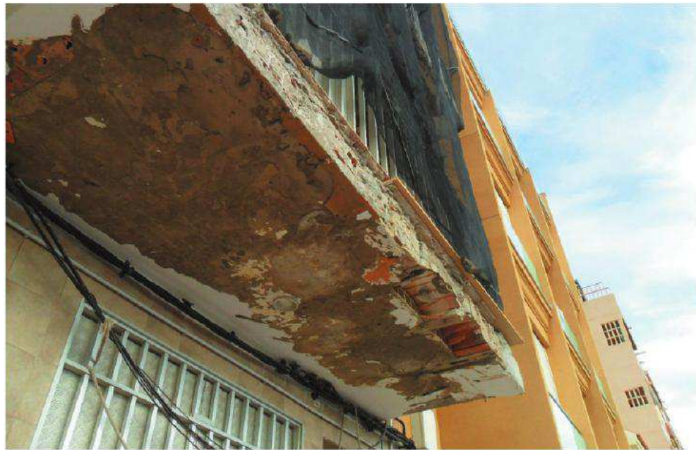
desprendimientos de tipo continuo, y suciedad por lavado diferencial.
