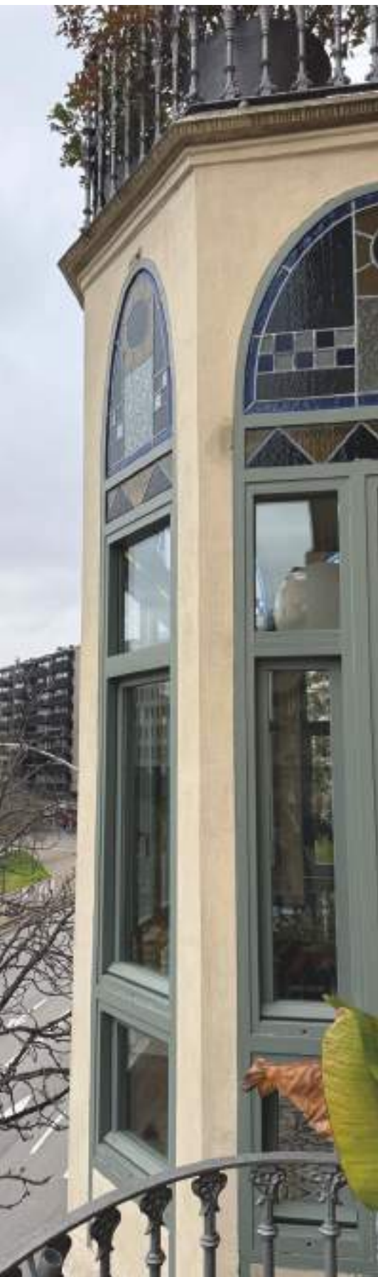
Imatges de l'estat final després de l'execució de les obres. Fotografies: Pere Duran.
