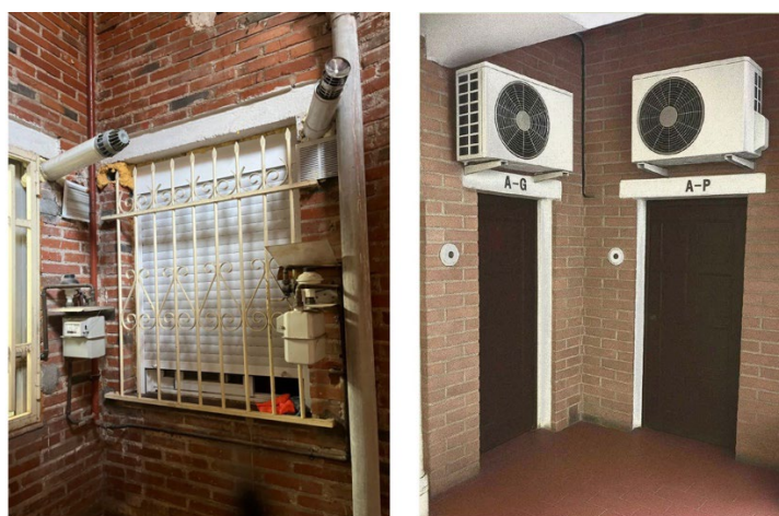
Figura 7. Imágenes del estado que presentan las instalaciones
