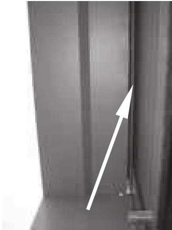
Figura 6. Holgura entre el cajón-chapa.
