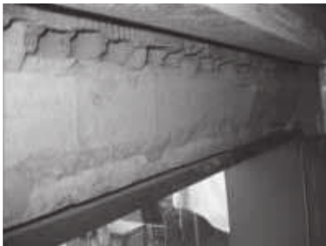
Figura 4. Apertura entre el cargadero-chapa.
