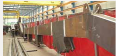
VISTA D'UNA DE LES BIGUES INFERIORS DE LA VOLADA 1 DEL NIVELL +29,86. SÓN LES PRIMERES PECES A COL·LOCAR, LES QUALS VAN ESTINTOLADES A L'ESPERA D'ACOBLAR AMB EL PRIMER MÒDUL QUE RECULL TOTS ELS ANCORATGES. A LA VEGADA, AQUESTA BIGA ARMADA PORTA LA PREPARACIÓ D'UN TIRANT D'UNA PLANTA INFERIOR PENJADA, LA DEL NIVELL +24,74, SALA D'EXPOSICIONS
