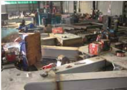
VISTA GENERAL DE L'ACOBLEMENT DELS ANCORATGES AL PRIMER MÒDUL. ES TRACTA LA ZONA ON, A MÉS, ELS HEB-400 I IPE-400 ESTAN TANCATS AMB XAPONS PER PRECISAR MAJOR RIGIDESA QUE LA RESTA DE L'ESTRUCTURA
