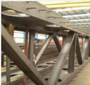
VISTA D'UN DELS CONJUNTS ACOBLATS. EN AQUEST CAS ES TRACTA DELS TRAMS EXTREMS DEL FORJAT INCLINAT DE LA SALA D'ACTES ON HI HA UNA SÈRIE DE BIGUES DE LIGAT ENTRE LES BIGUES PRINCIPALS O BIGUES BOYD
